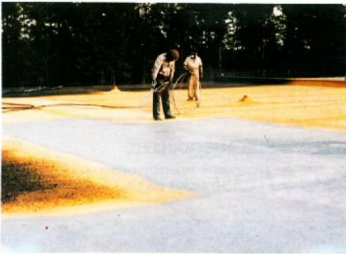
ΜΟΝΩΣΕΙΣ ΤΑΡΑΤΣΑΣ: Spray με πιστόλι. Τα δύο υλικά του ψεκασμού μετατρέπονται, σε διάστημα δευτερολέπτων σε στερεοποιημένο, σκληρό και ελαφρύ στρώμα άφρον.
